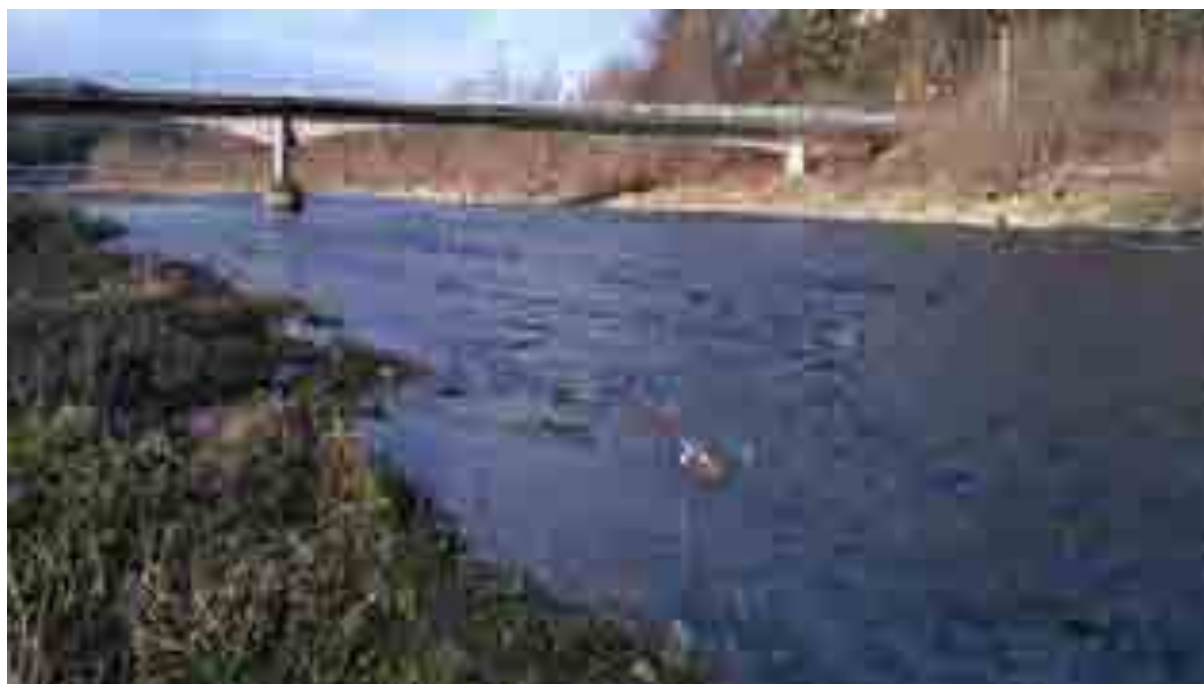
Fot. 2.7 Częściowe zasypanie wyrw w dnie podmywających filary mostu, osiągnięte przez uformowanie sekwencji bystrzy żwirowo-kamiennych i uruchomienie części żwirów odłożonych w wyższych częściach dorzecza. Forma wykonania Działania 5.1. Fot. I. Biedroń
