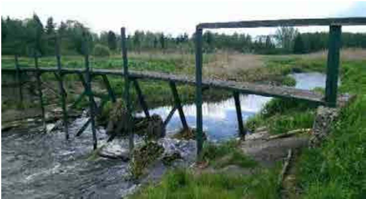
Fot. 7.9 Zniszczone urządzenia wodne tracą funkcję i zwiększają ryzyko powodziowe poprzez akumulację rumoszu, co wymaga zwiększenia nakładów na prace utrzymaniowe. Fot. M. Grygoruk
