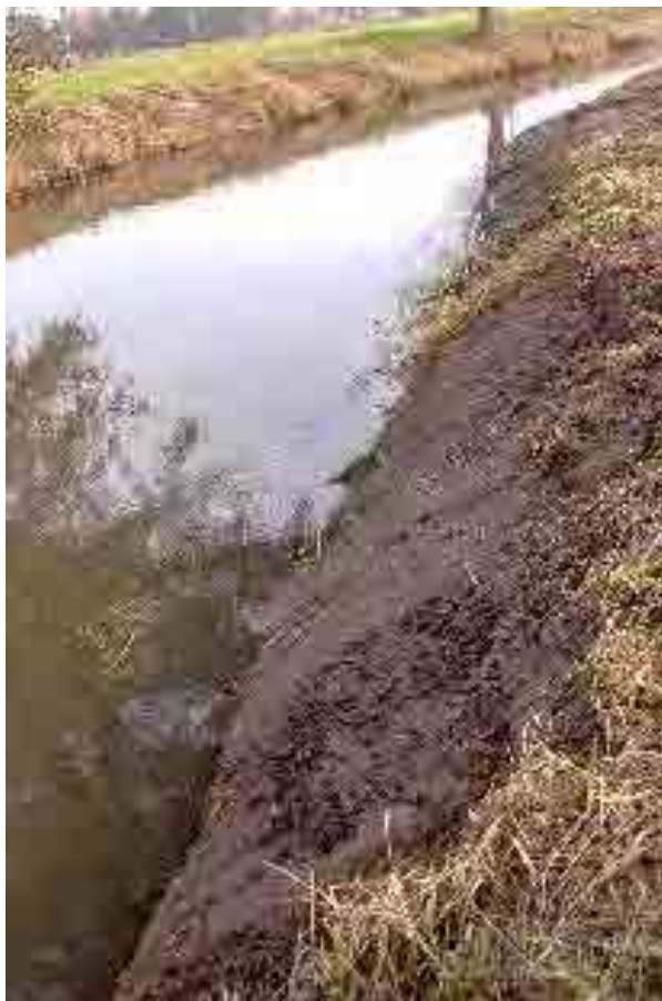
Fot. 3. W celu ograniczenia negatywnego oddziaływania prac na środowisko rzeki należałoby ograniczyć ingerencję w brzegi rzeki. Fot. P. Fiedorczuk
