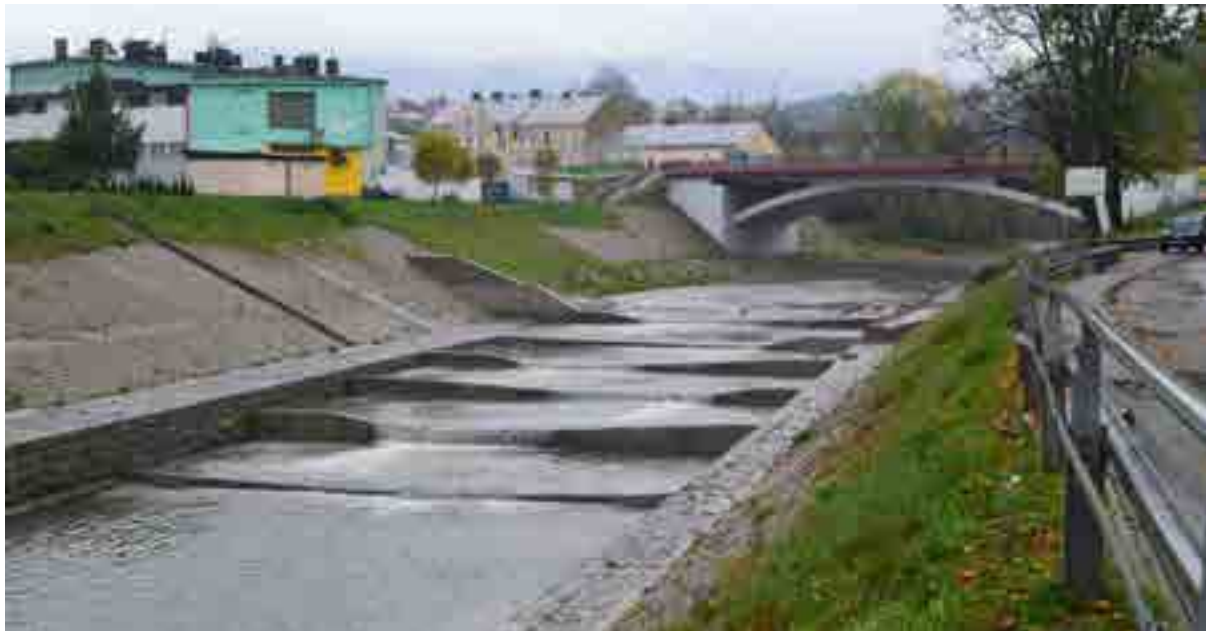
Fot. 20. Stopień na Białej w Grybowie – po modernizacji. Wysoki próg został zastąpiony kaskadą niższych stopni o nieregularnej koronie umożliwiającej zmiany rozkładu prędkości nurtu. Zmodernizowany stopień wodny nie stanowi bariery dla migrujących ryb. Źródło: archiwum RZGW w Krakowie
