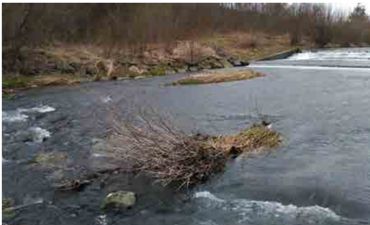
Fot. 12. Widok od strony bystrza na stopień w km 4+672 potoku Krzczonówka. Fot. I. Biedroń
